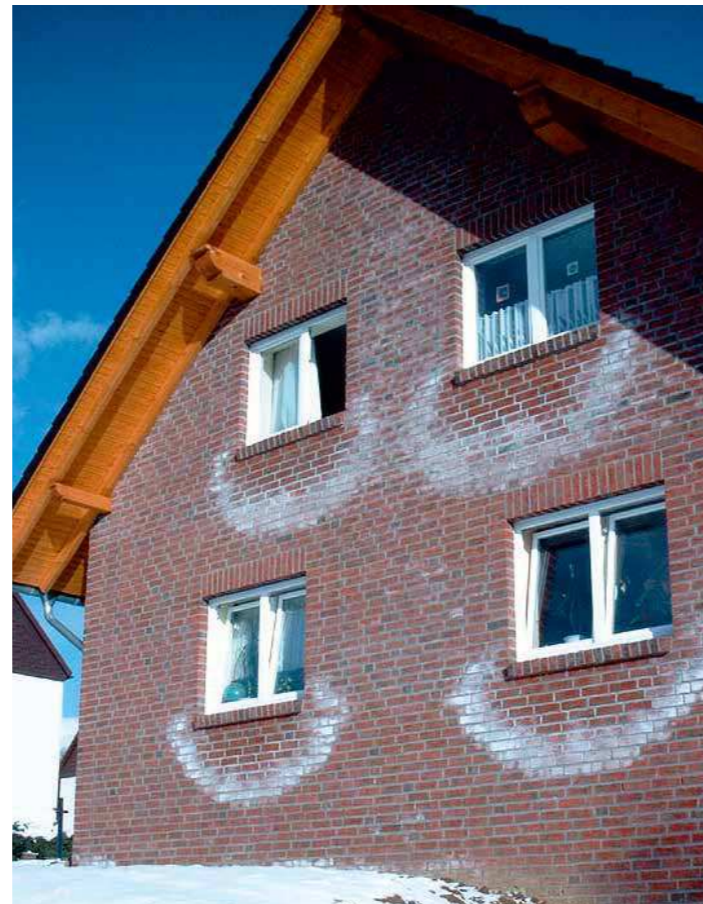
Wykwity (tu na zdjęciu tak zwane „worki na wodę”), spowodowane przez wodę deszczową, która przeniknęła do muru przez konwencjonalnie murowane parapety okienne.
